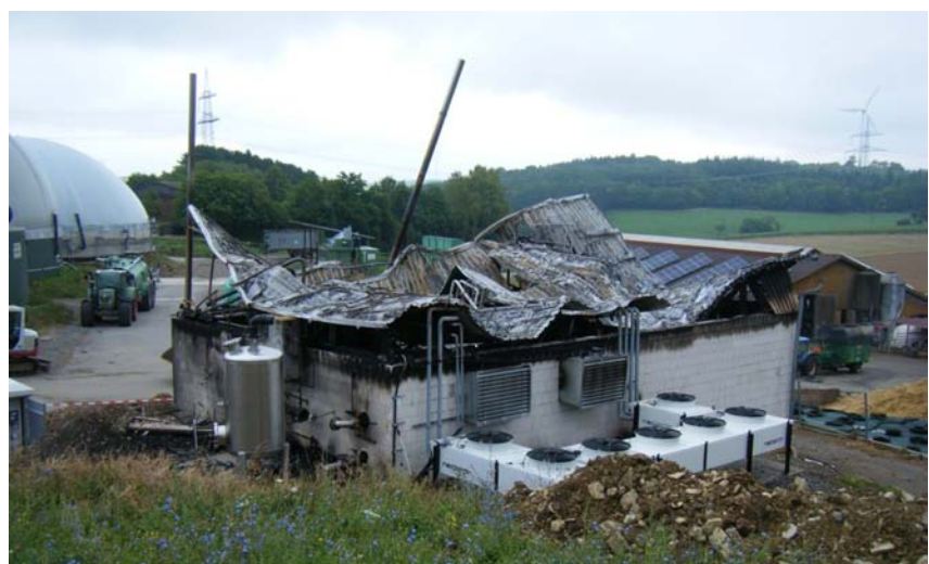
Durch einen Brand wurde ein Blockheizkraftwerk total zerstört.
