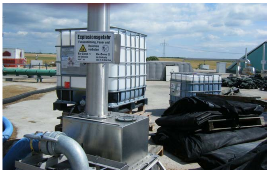
Hinweis auf Explosionsgefahr an einer Biogasanlage.
